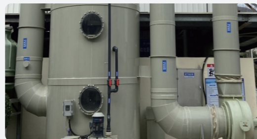
废气处理装置
