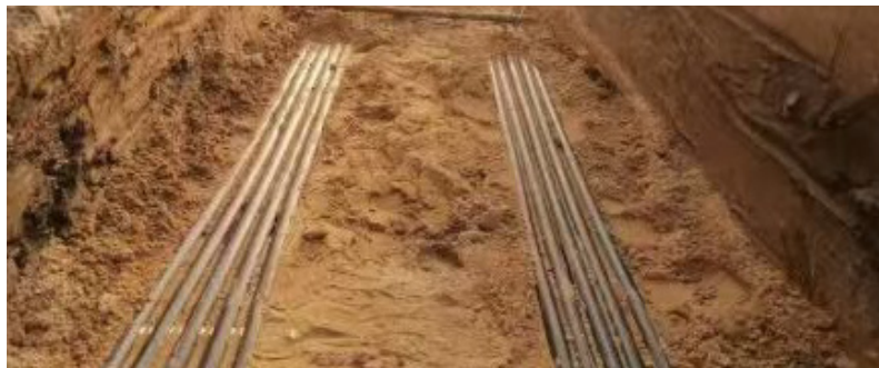
华东总部基地建设地源热泵系统设备设施
