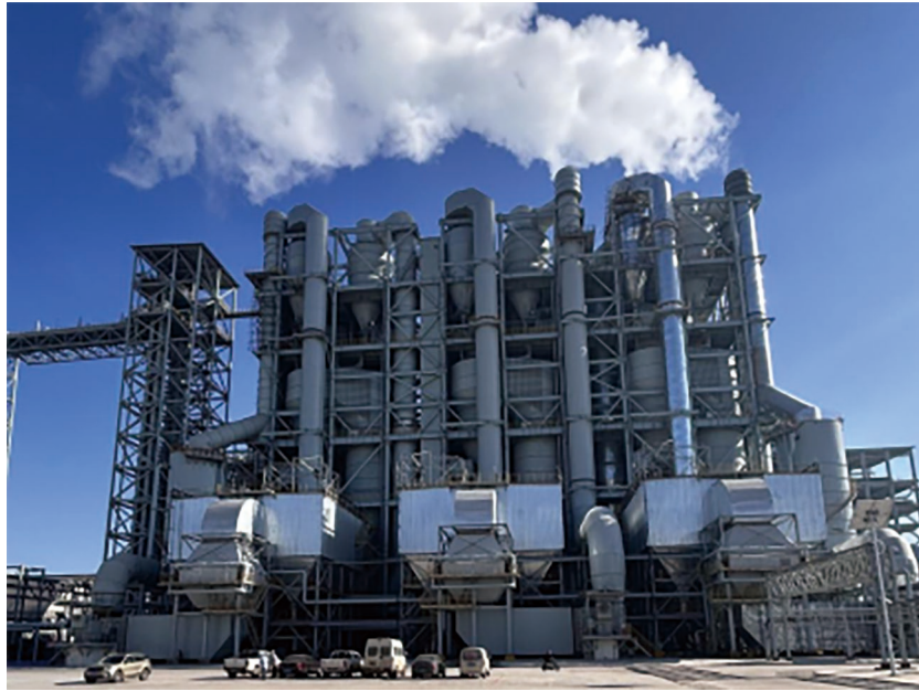
大型高效氧化鋁氣態懸浮焙燒爐
