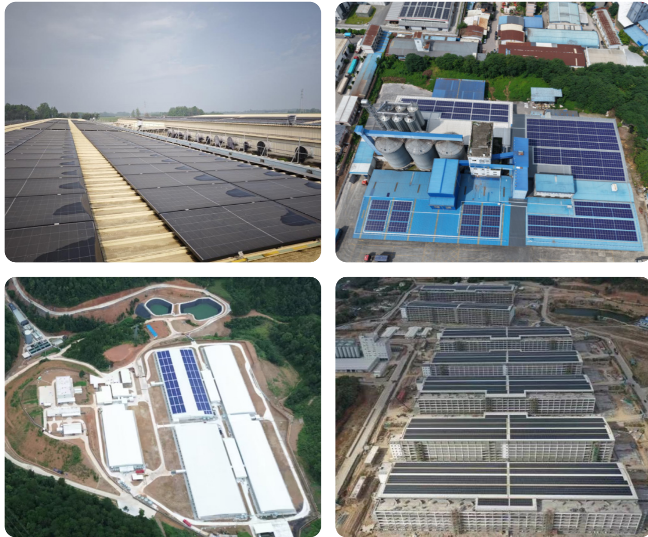
公司下属饲料生产基地和生猪养殖基地安装屋顶光伏
