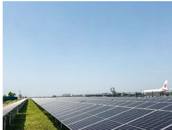
首都國際機場飛行區中跑道東側地面光伏設施
