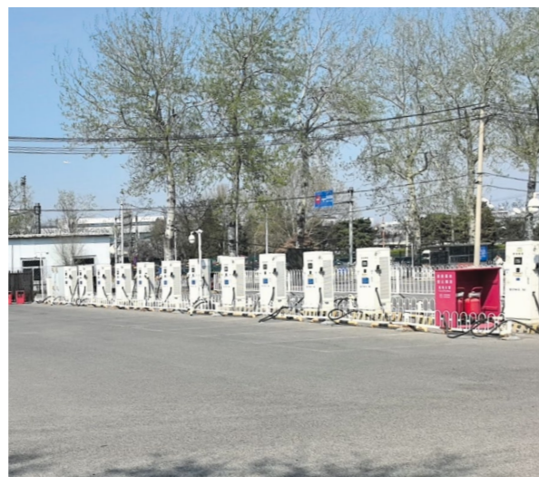
首都國際機場公共區域充電樁
