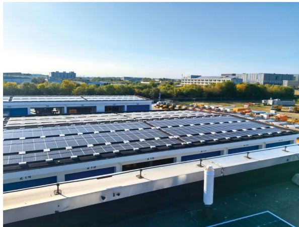
首都國際機場飛行區新場務屋頂光伏設施
