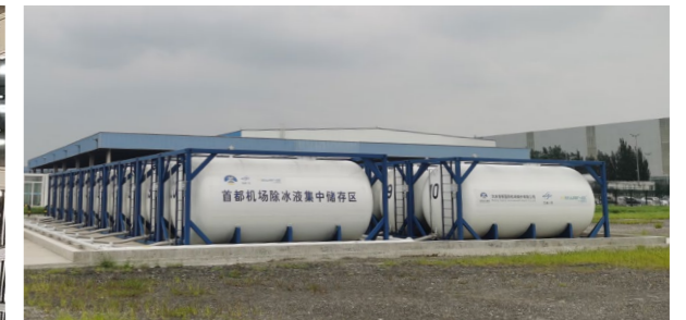
首都國際機場除冰廢液回收
