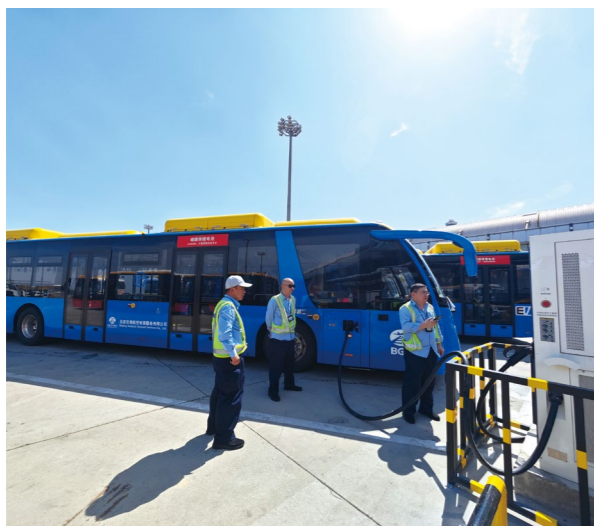
首都國際機場飛行區充電樁
