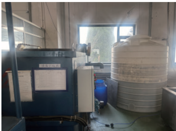
维修区污水处理设施
