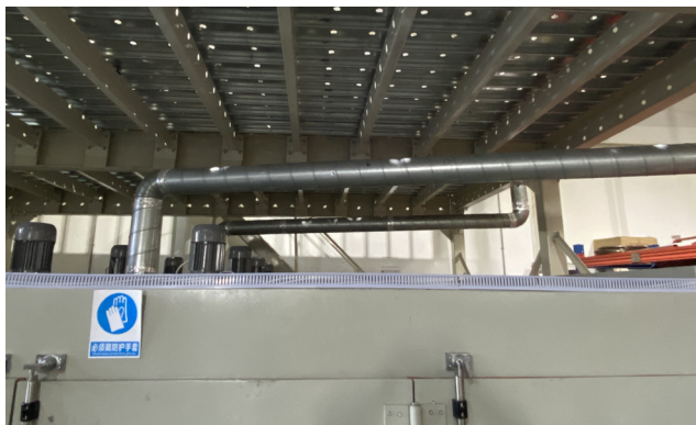
优泰科浇注车间烘箱接入废气处置设施
