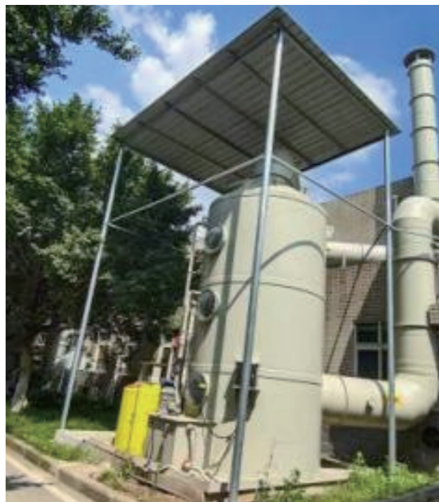
阳极氧化自动化酸雾治理设施
