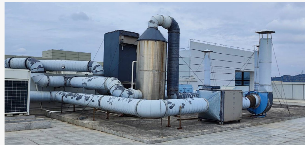
▲ 废气处理设施
