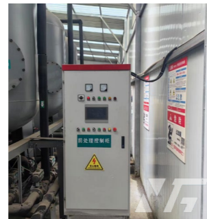
废气处理装置
