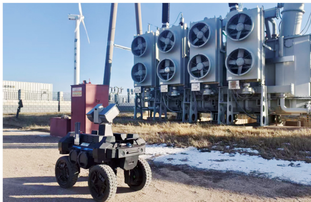
首台智能巡检机器人在辉腾锡勒风电场成功投入运行
