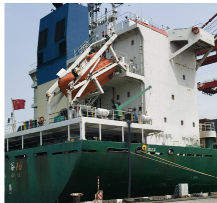
船舶岸电装置
