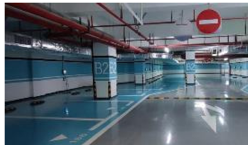
调整后的电箱及地库
