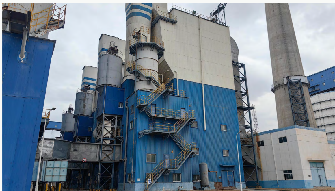
超低排放改造石灰石仓
