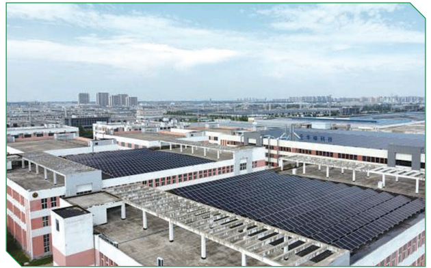
光宿城開發區屋頂光伏發電項目於2024年10月並網發電，設計發電裝機容量為40兆瓦，是本集團裝機容量最大的光伏項目。
