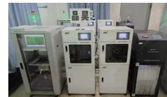
废水处理设施
