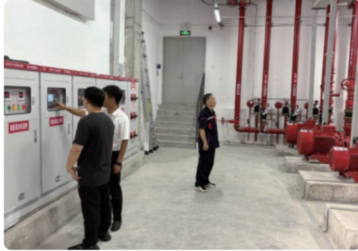
安全隐患排查
