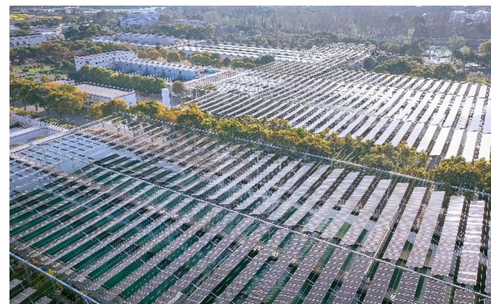
肖山水厂光伏实景图
