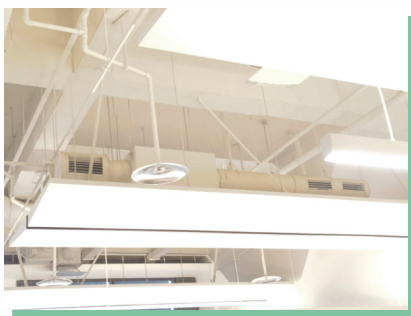
空氣淨化設備
