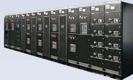
数据中心电源模块
