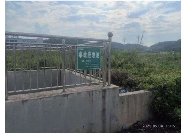
废水排放事故应急池
