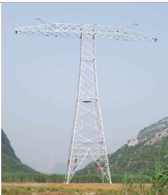
800KV 特高压直流输电线路铁塔
