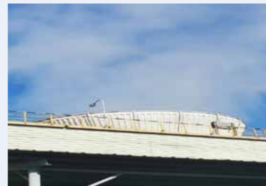
改造前：顶部水蒸气全部挥发到空气中
