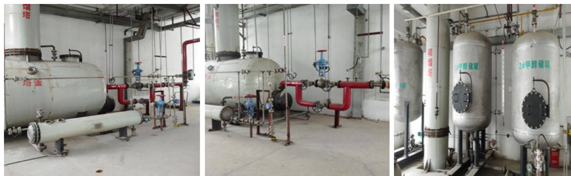
甲醇母液精馏回收塔
