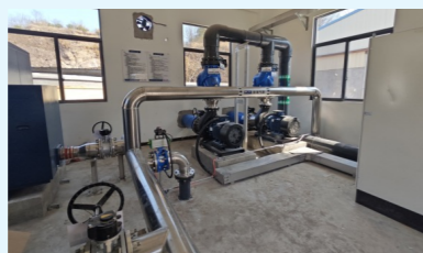
桐城市卅铺自来水厂反洗气管
