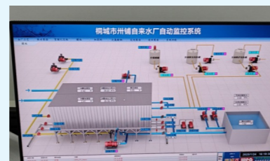
桐城市卅铺自来水厂自动监控系统
