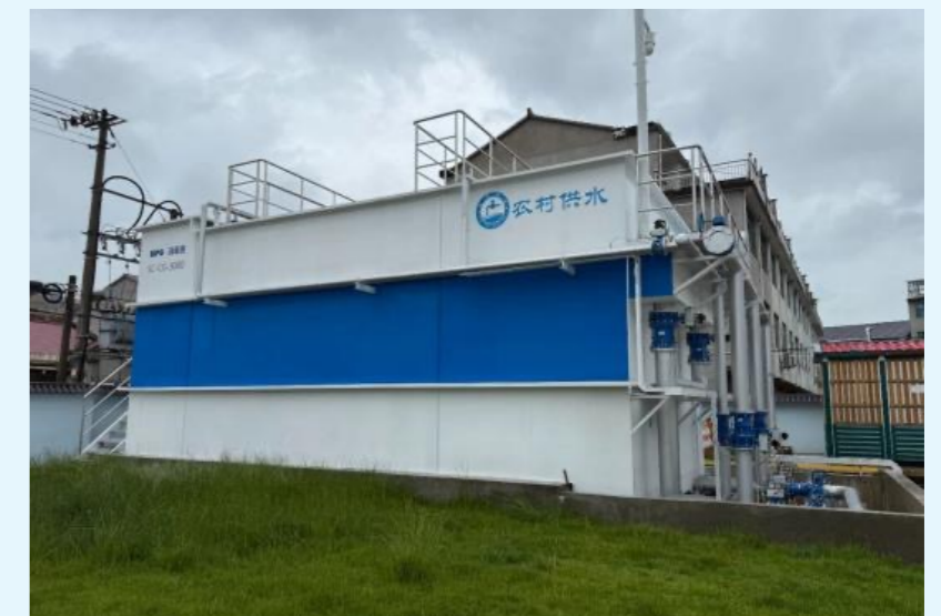
威派格回山水厂
