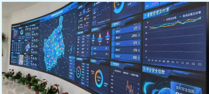
数字孪生试点项目构建水厂管控平台
