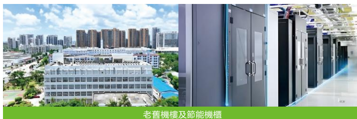
老舊機樓及節能機櫃
