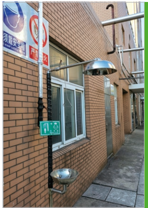
車間與倉庫區域 配備洗眼器
