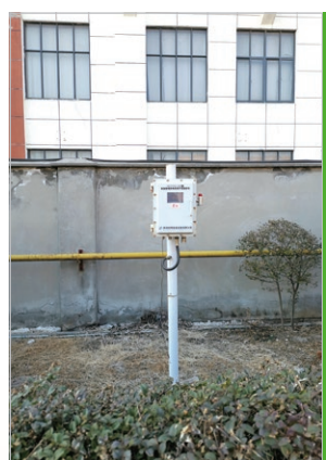
廠區配備大氣VOCs 監控設備
