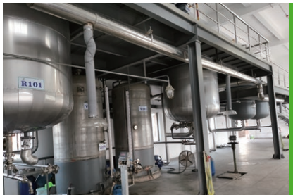
運作車間配備活性炭氣體吸收系統
