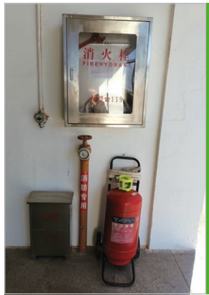
生產車間附近設置消防器材
