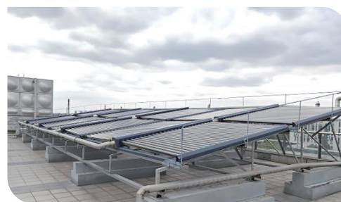
闵行检测园太阳能热水系统
