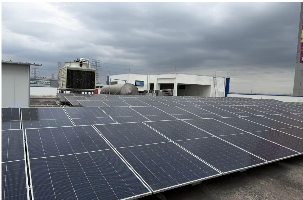
东莞厂房屋顶光伏系统
