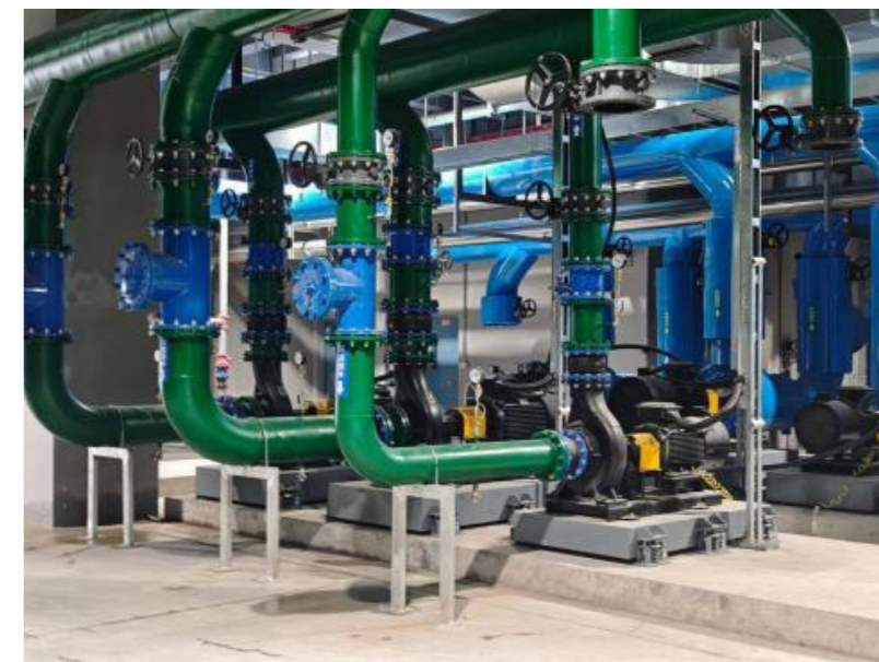
亿帆医药车间浓水回收系统
