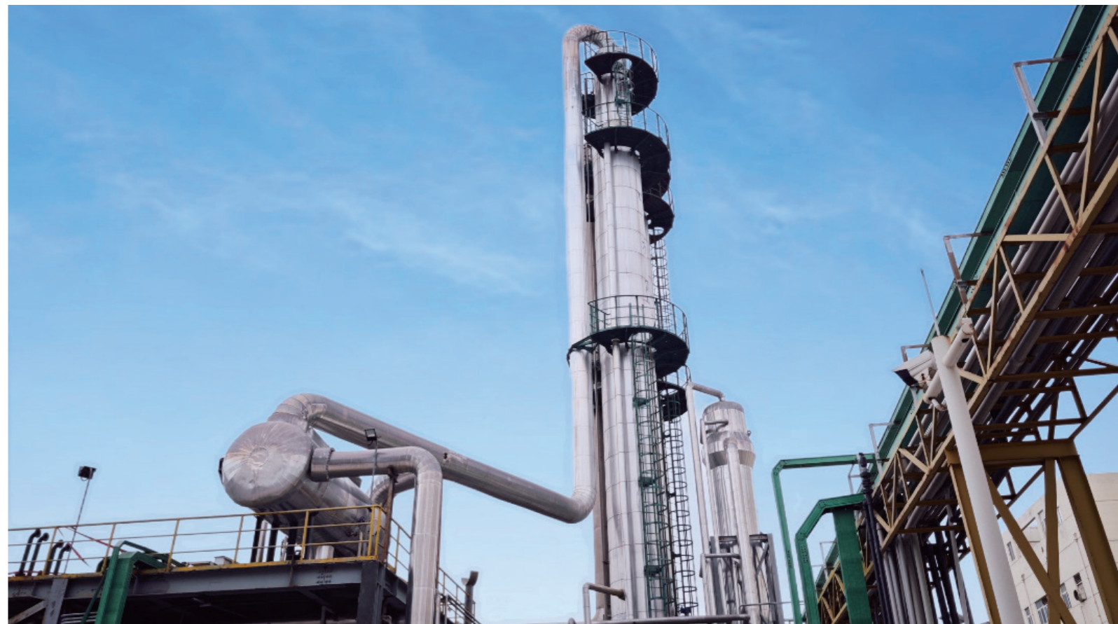
废水处理设施
