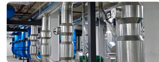
冷却水循环设备
