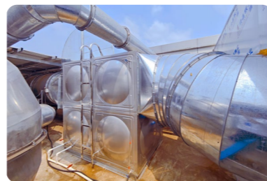
粉尘处理排放系统
