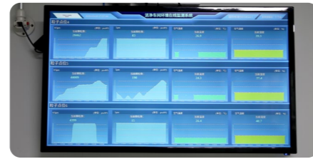
洁净车间环境在线监测系统
