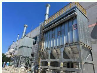
脉冲除尘设备
