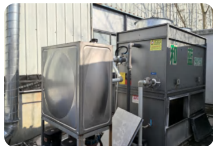
冷却循环水塔
