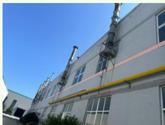
燃烧废气净化设备
