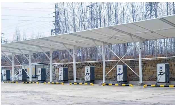
鹤壁市能能无忧重卡充电站
