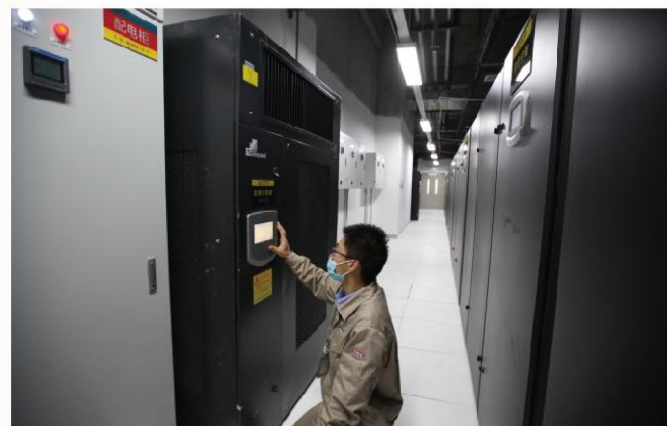
西咸数据中心日常设备维护
