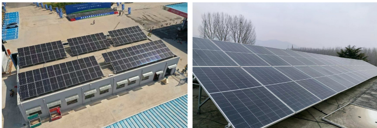
泰山石油光伏项目
