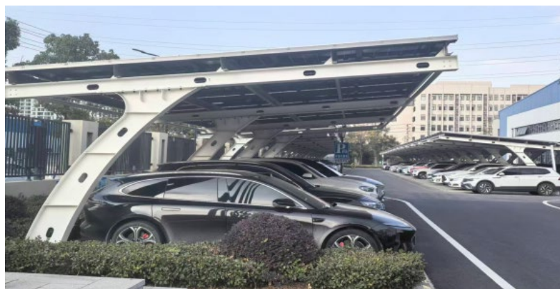
↑ 停车棚屋顶光伏照片
