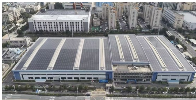
↑ 建筑屋顶光伏照片
