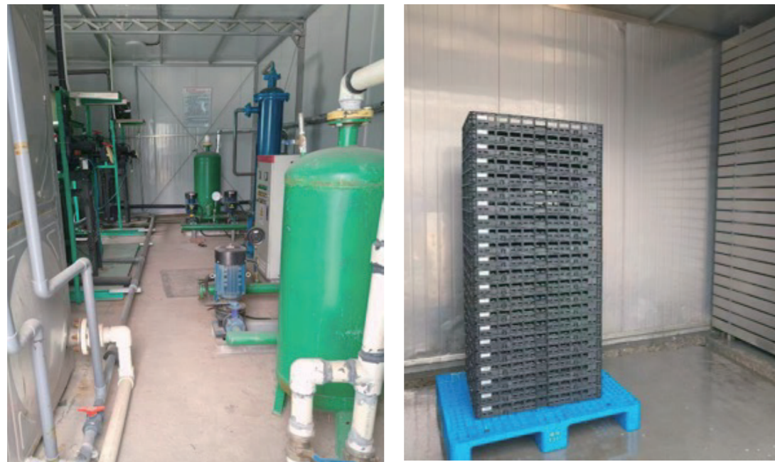
蒸汽冷凝水循环系统
