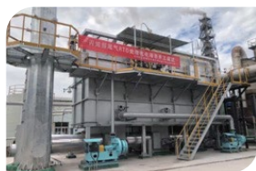
有机废气净化装备及工程
