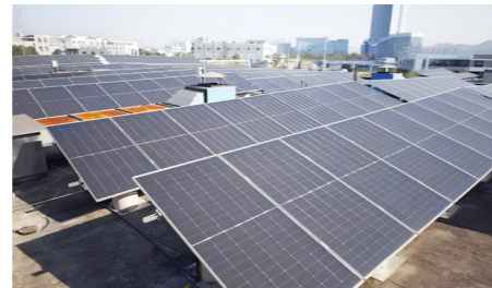
厂房屋顶光伏发电设施
