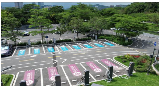
图 23 笔架山公园南门光储充放示范站
