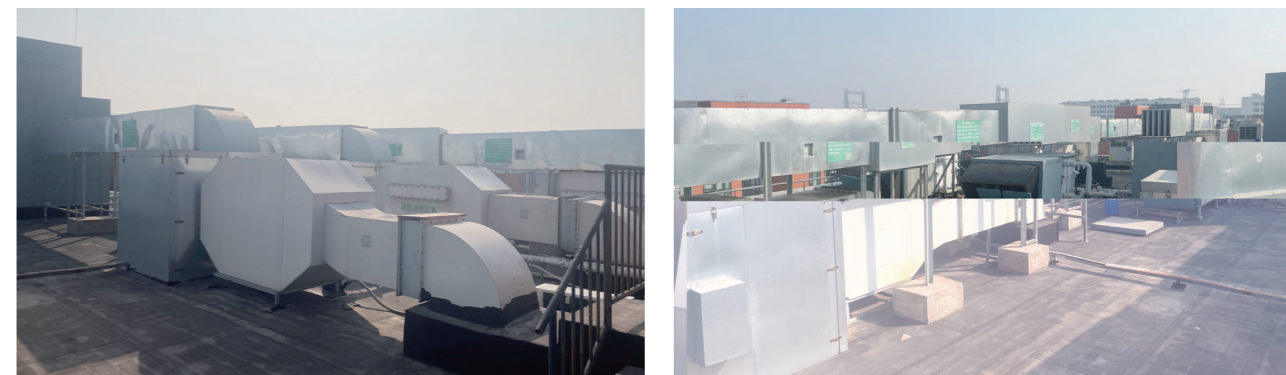
废气处理设施
