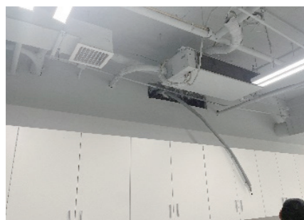
通风管线整改前
