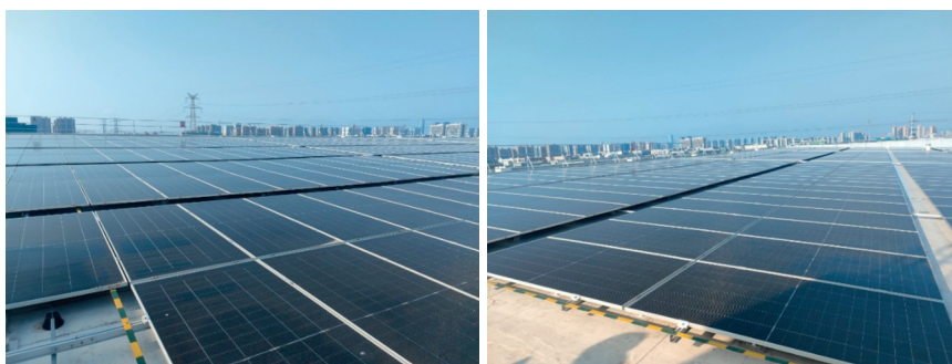
圖註：新能一期屋頂光伏
