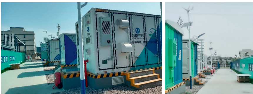
圖註：正力新能儲能電站
