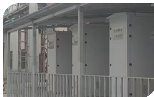
▲ 光伏发电系统
