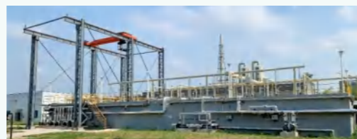
國瑞藥業廢水循環處理站
