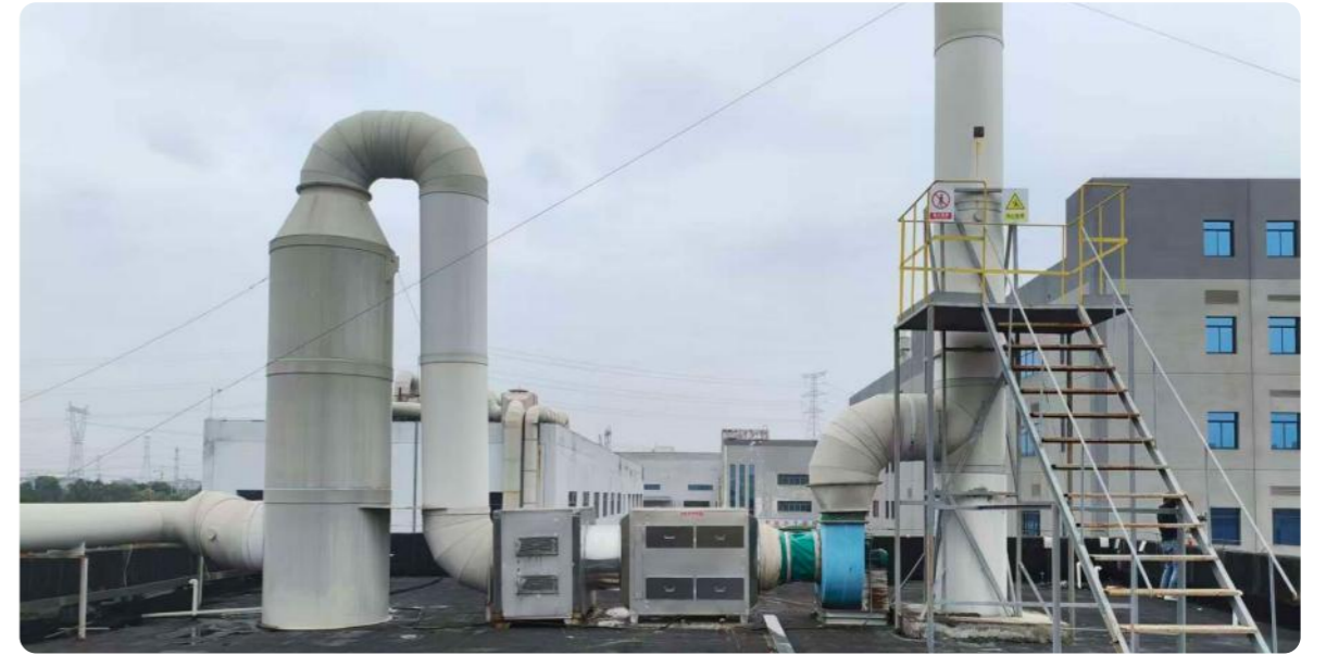
改造後的危險廢物庫廢氣治理設施（二級活性炭吸附）
