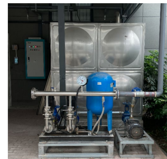
DI 废水循环系统
