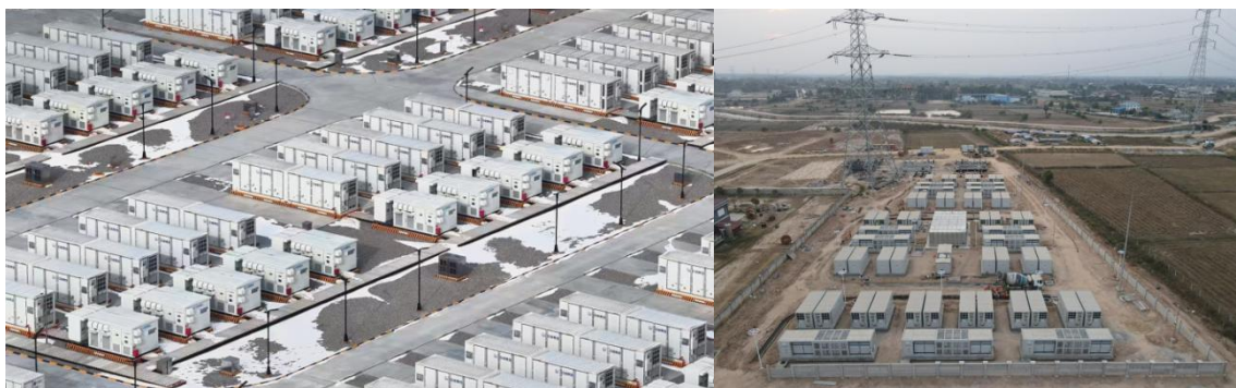
图：嘉峪关 500MW/1000MWh 独立储能项目和柬埔寨构网型 62.5MW/125MWh 储能项目
