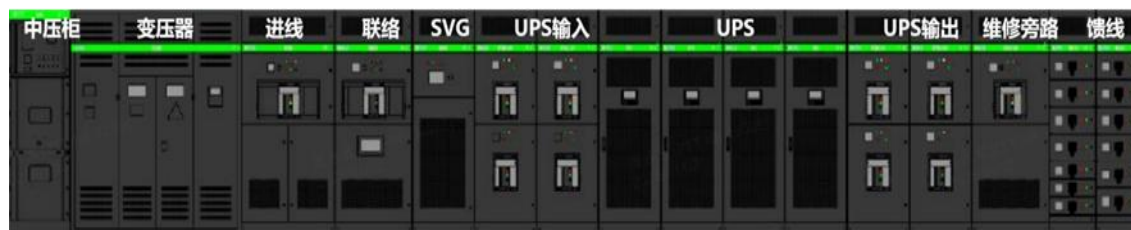
图：算力中心一体化电力模组
