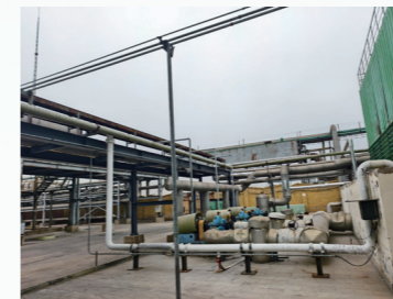
化纤公司实施兴达动力车三四五 线吸附脱硫酸废水回用项目
