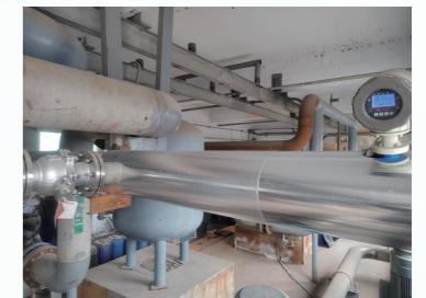
化纤公司实施远达动力一车间废 气回收废水回收综合利用
