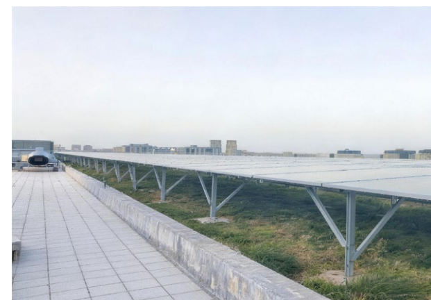
光伏發電系統
