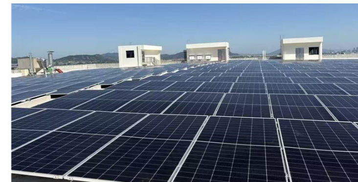
厂区屋顶分布式光伏
