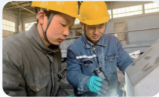
检查不停电启停槽装置
